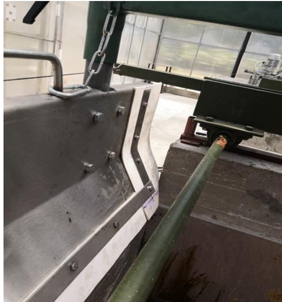
Εικόνα 4.35: Εφαρμογή αλυσίδας συγκράτησης στα ξέστρα του κατακόρυφου συστήματος ξήρανσης
