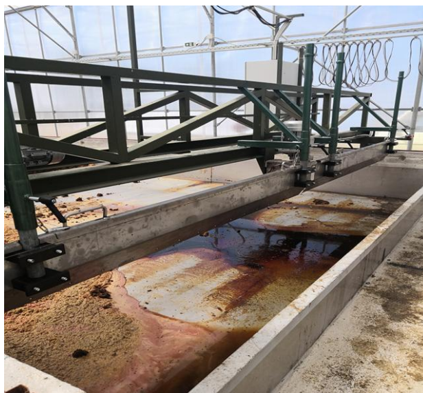
Εικόνα 4.39: Ενσωμάτωση του μηχανισμού πτυσσόμενων ξέστρων στο αυτοματοποιημένο σύστημα ανάδευσης της δεξαμενής
