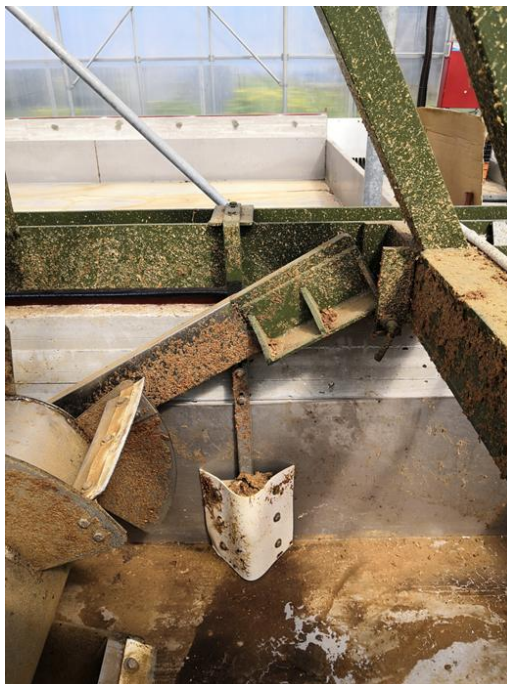
Εικόνα 4.22: Μεταφορά πλευρικών υφιστάμενων ξέστρων
