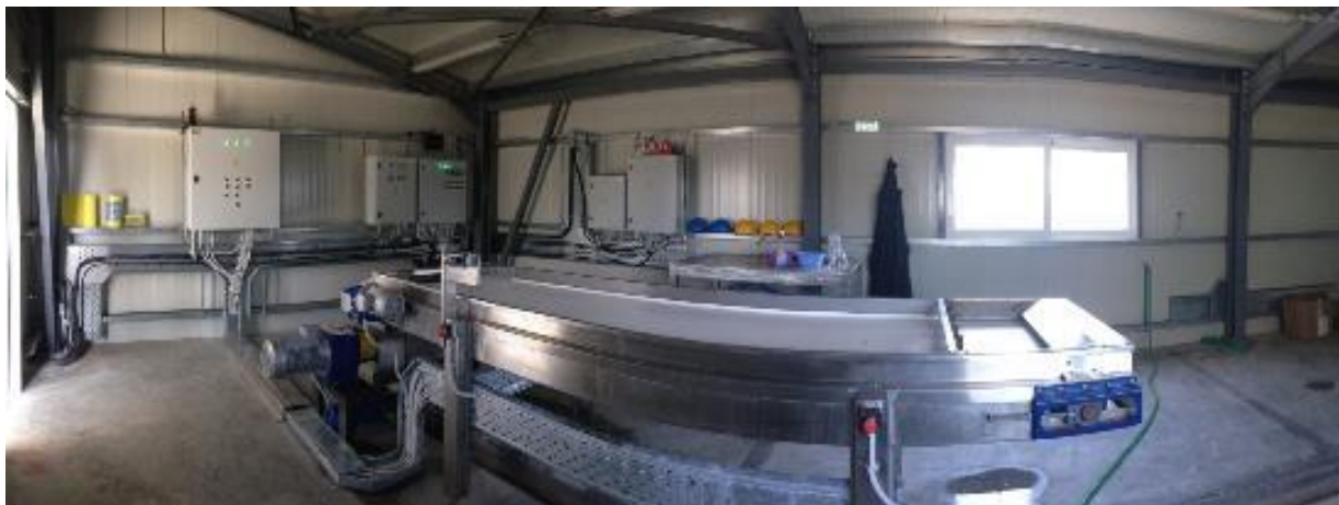
Εικόνα 4.2: Εξωτερική άποψη μονάδας προεπεξεργασίας.
