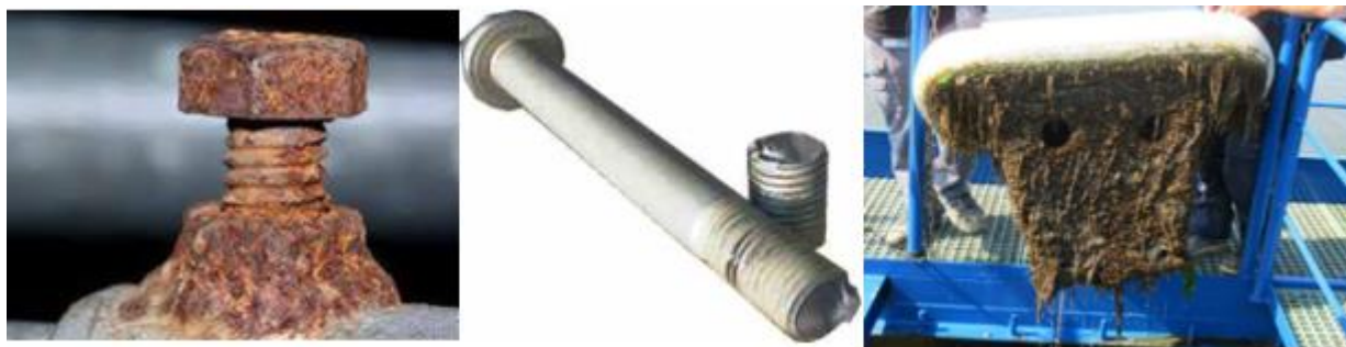
Εικόνα 3-1: α) διάβρωση β) κόπωση γ) θαλάσσια ανάπτυξη.
