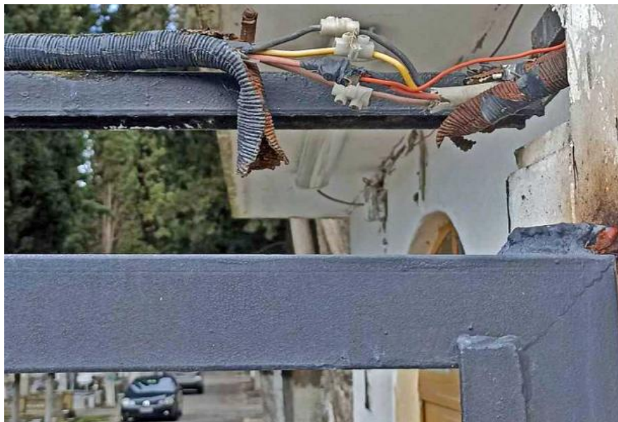
Εικόνα 5 Εκτεθειμένα ηλεκτρικά καλώδια.
